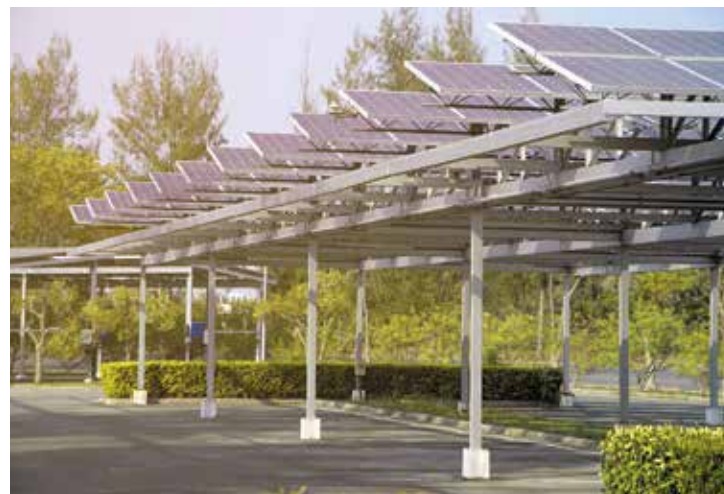
Photovoltaik auf einer Überdachung eines Parkplatzes
