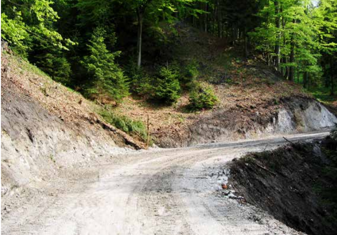
Auch wenn der Weg zweckmäßig erscheint, kann die Behörde den Rückbau eines Weges anordnen, der eben erst gebaut wurde, wenn die gesetzlichen Bestimmungen für den Bau einer Forststraße nicht eingehalten wurden.
