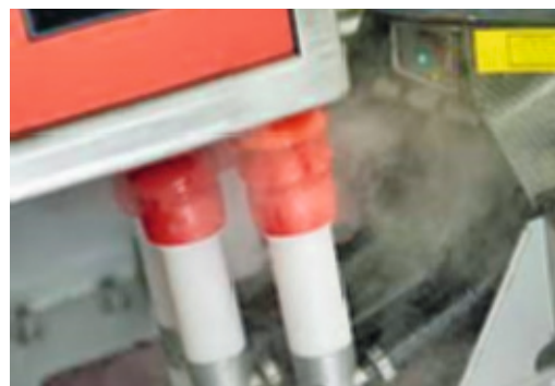
Foto 20: Zwischendesinfektionsanlage mit Heißdampf.
