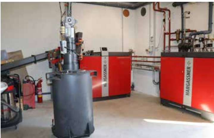
Diese Kraft-Wärme-Kopplungsanlage steht auf einem Mostviertler Betrieb und erzeugt aus Hackschnitzeln Wärme & Strom. Links im Bild ist der Vergaser, rechts der Stromerzeuger zu sehen.
