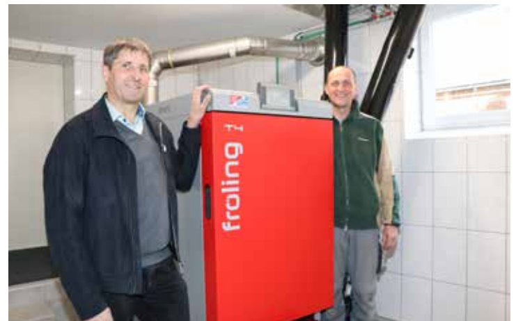
Dieser Hackgutkessel ist mit einem Brennwertwärmetauscher ausgestattet, der auch dem Abgas noch Wärme entzieht. Das Abgas kühlt so stark ab, dass die Temperatur im Kamin konstant bei 45 °C bis 55 °C liegt.
