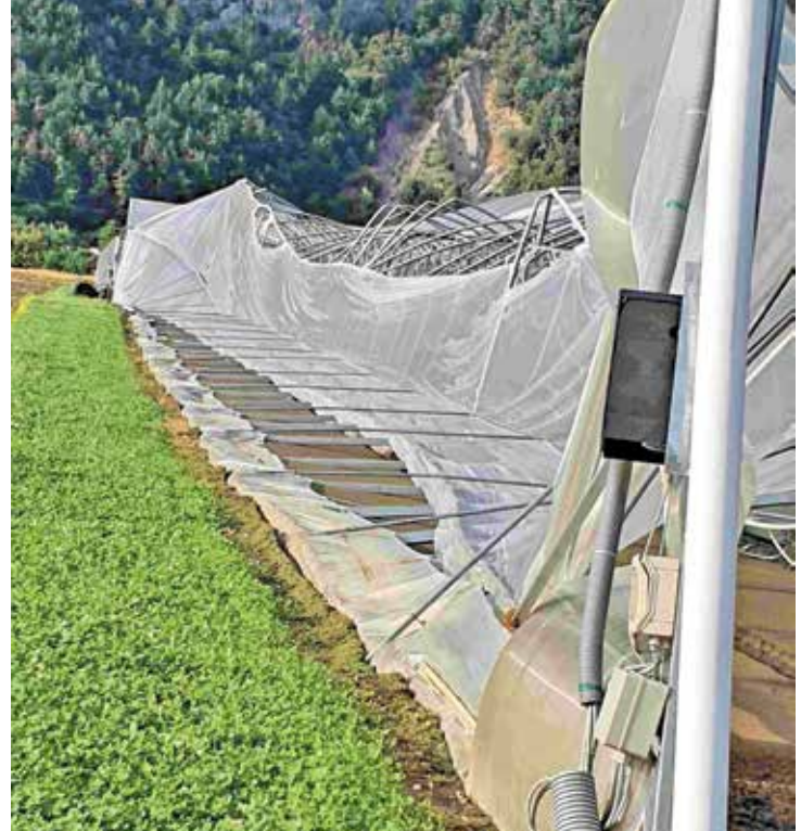
Sturmschäden bei Folienhaus in Tirol
