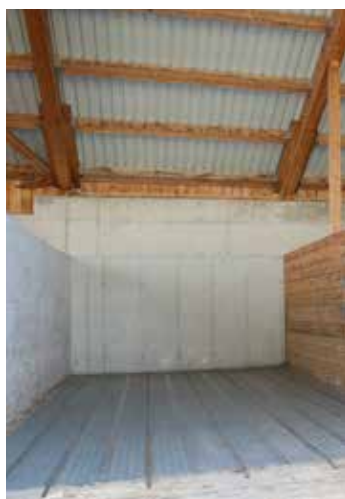
Die Trocknungsboxen sind mit einem verzinkten Rostboden ausgestattet. Über Schlitzbleche bläst Thomas Zöchling warme Luft ein.
