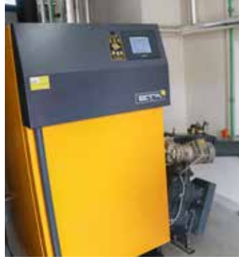
Biomassekessel verwerten das Brenngut hoch effizient.
