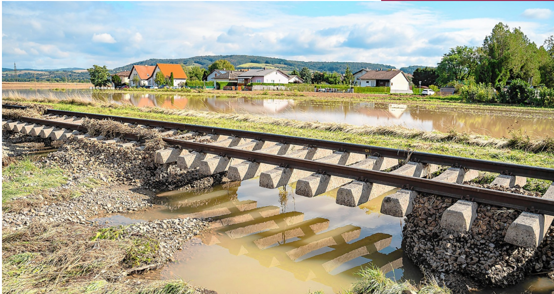
▲ Das Tullnerfeld im September 2024: Die Bahnstrecke ist unterspült, der Zugverkehr muss monatelang über die alte Westbahnstrecke umgeleitet werden. Foto: ÖBB
