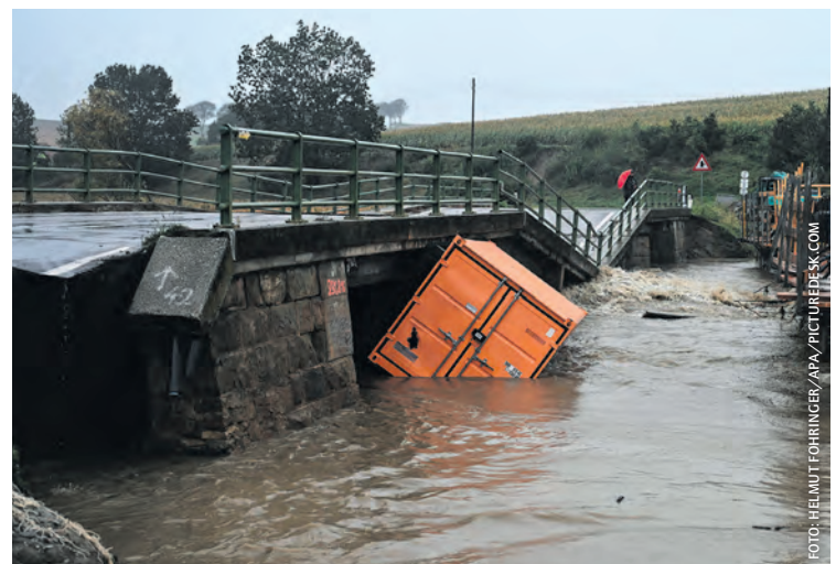
Die massiven Wassermassen von 200 Liter/Quadratmeter und mehr haben die Infrastruktur vielerorts geschädigt, in Böheimkirchen etwa diese Brücke.
